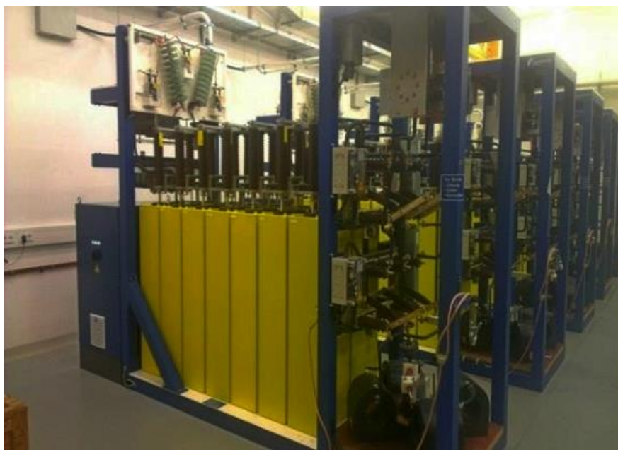
Рисунок 2.4.1. Общий вид на зал с банками конденсаторов
